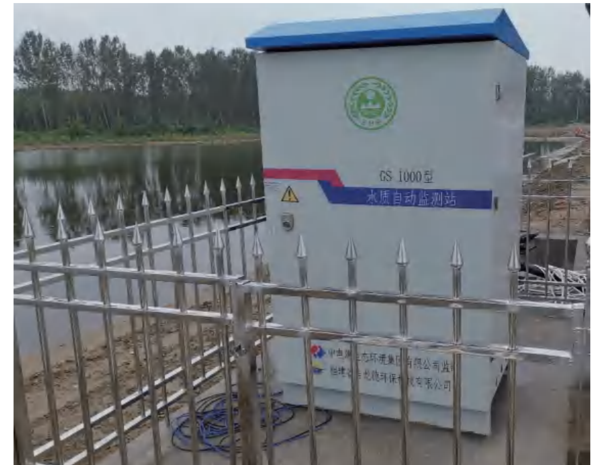
图28 雄安新区府河湿地净水工程的水质监测站
