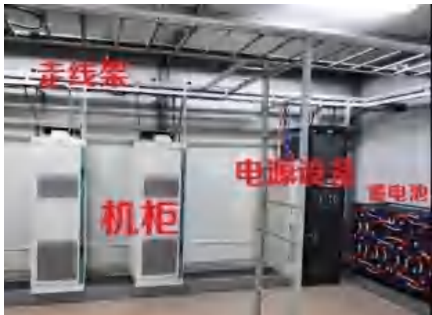
图35: 机房室内布局
