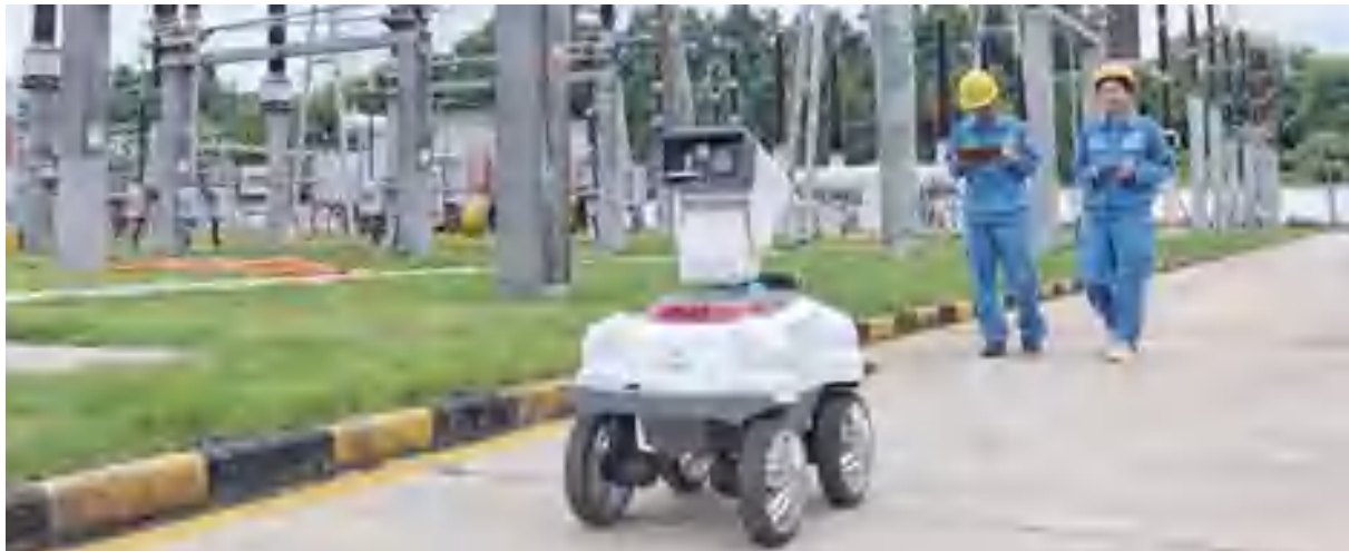
图: 8 5G 无人车干线电网智能巡检场景
